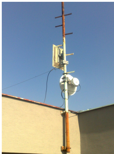
Obr. 4 – Parabola rádioreleového spoja na budove VÚS (v spodnej časti stožiaru)
