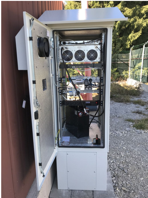
Obr. 6 – Skriňa na Panskom diele so zariadeniami T-DAB+
